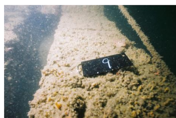
普通コンクリートの付着生物状況
