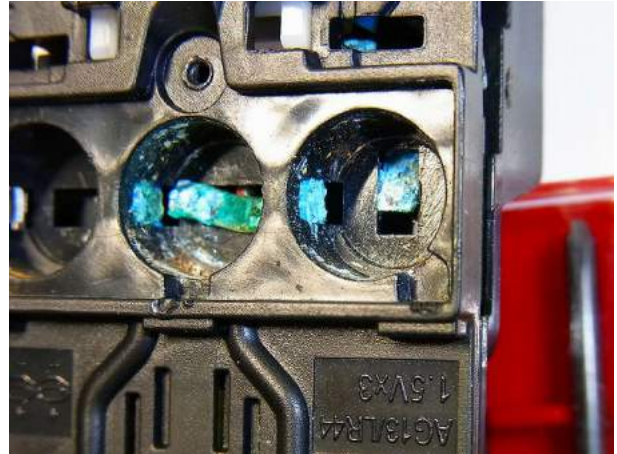
②ボタン電池LR44×3個が液漏れで全滅 漏れ出した電解液が周囲を著しく侵食していた
