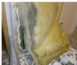
濡れた断熱材のカビ
