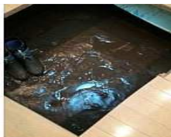
フローリング浸水の床下
