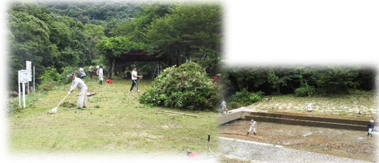
プールに溜まった土砂は地元の業者さんが撤去してくださいました。
